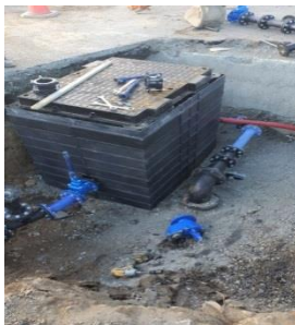
PRV Milltown Lane
